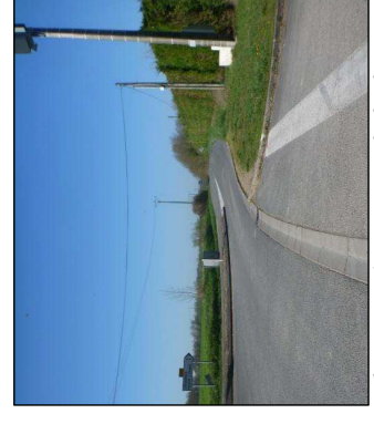
Pylône électrique HTA et son poste de distribution publique Source : L'Artifex 2017
